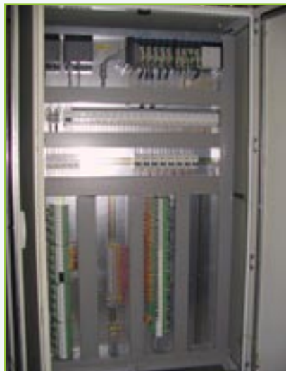
Overzichtelijke en compacte kastenbouw dankzij PLC-RELAIS
