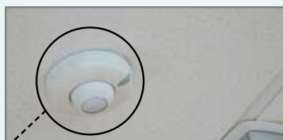
De bewegingsmelders detecteren of er iemand in de ruimte is en sturen draadloos een signaal naar een ontvanger in het vals plafond.
