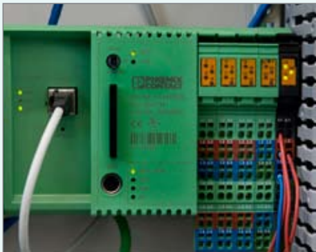
De centrale plc, een ILC 350 PN van Phoenix Contact, verwerkt de gegevens van de bewegingsmelders en stuurt de verlichting aan in de betreffende zone.
