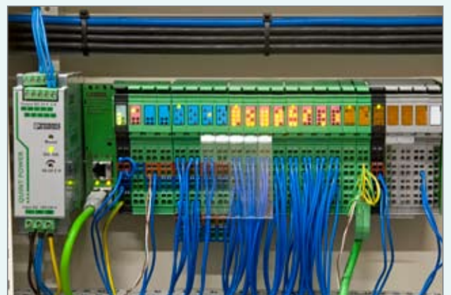
In elk van de vijf deelzones staat er een decentraal Profinet-I/O-station, met (rechts op de foto) een DALI-module voor de graduele aansturing van tl-armaturen.
